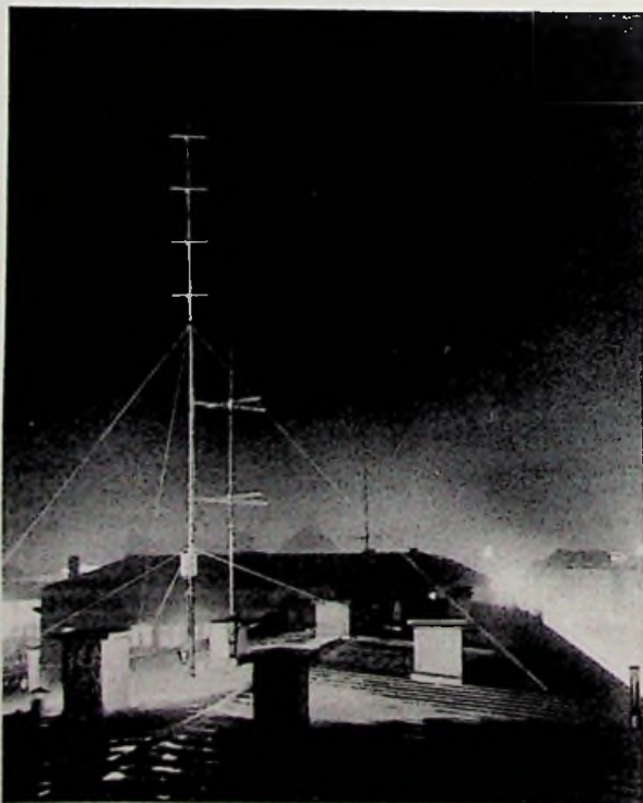
Mit dieser Kathrein-Vierebenen-Antenne wird im Zentrum von München der Fernsehsender Feldberg im Taunus empfangen. Unten am Mast der wasserdicht gekapselte Antennenverstärker
